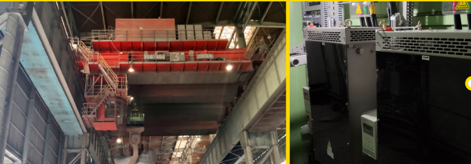
重庆钢铁2台350T铸造吊 主钩电机620KW×2 原ABB调压改造为QY3-1000S-A 690V 2台一拖一驱动
